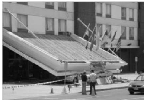
Figura 7 Colapso de cornisa en Hotel Radisson. Terremoto de Quillahuá Chile ( 2007)
