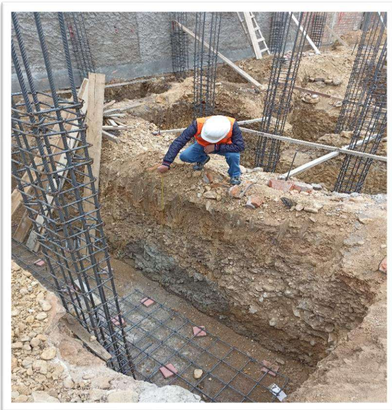
Vista 04.- En la vista se observa la verificación de la altura de zapatas.
