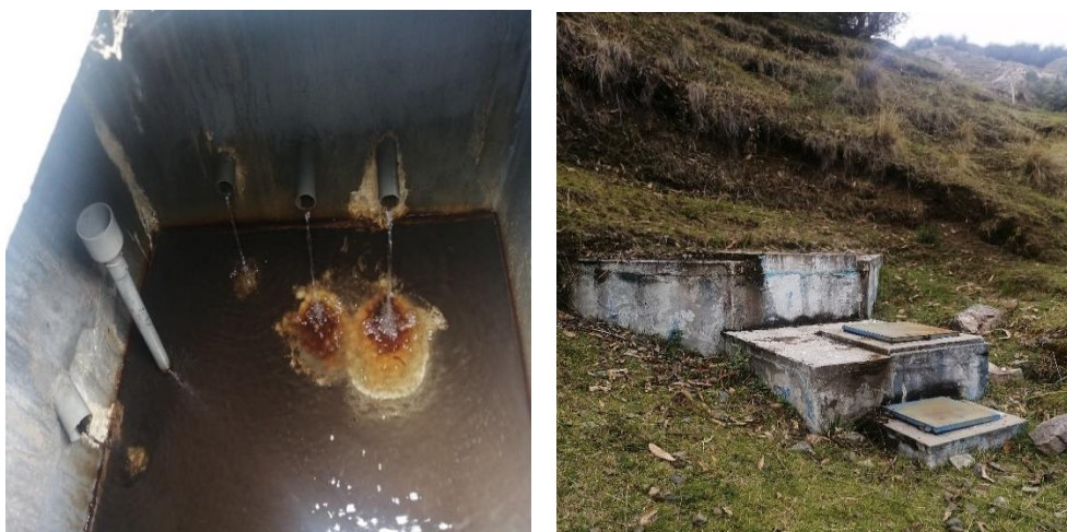
Figura 5.9. Vista externa e interna de la captación n° 03
