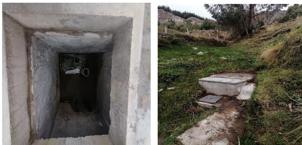
Figura 5.8. Vista externa e interna de la captación n°02
