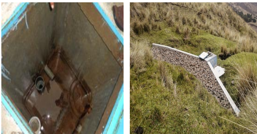
Figura 5.10. Vista externa e interna de la captación n° 04
