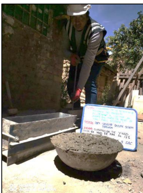
Fotografía N° 38: Elaboración de testigos rectangulares con adición del 12% de ceniza de hojas de pino para sus respectivos tipos de ensayos, según referencia de la norma NTP 339.034 / ASTM C39.
