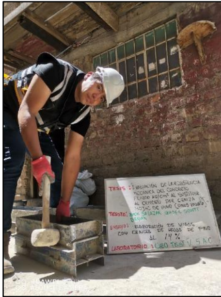
Fotografía N° 49: Elaboración de testigos rectangulares con adición del 14% de ceniza de hojas de pino para sus respectivos tipos de ensayos, según referencia de la norma NTP 339.034 / ASTM C39.
