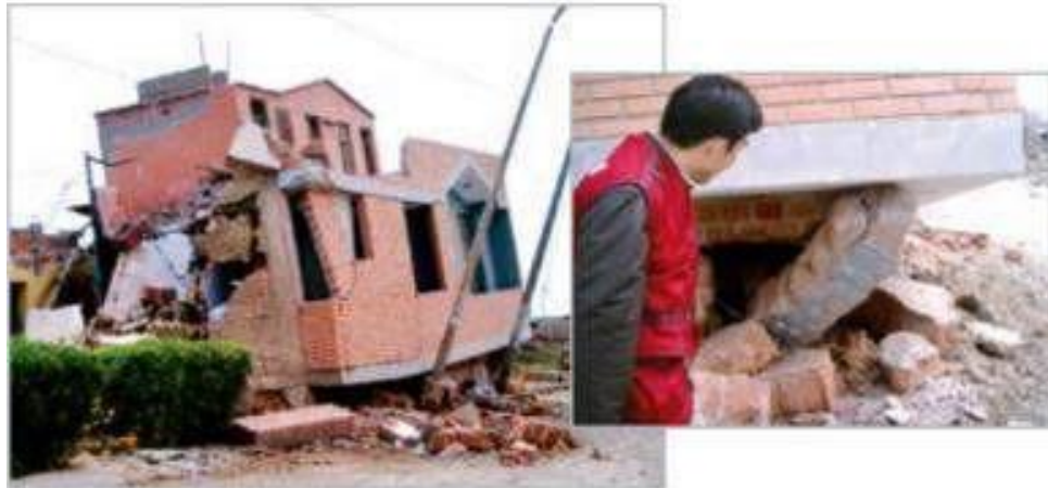
Figura N° 7: Vivienda dañada debido al terremoto de Pisco. 15 de agosto, 2017.
