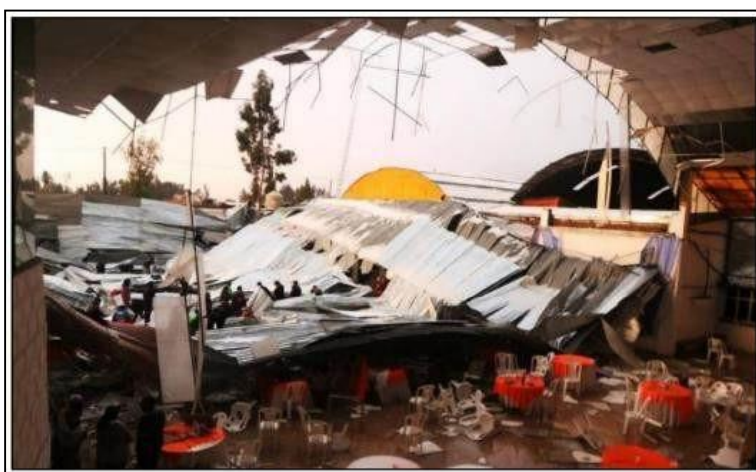
Figura N° 2: Caída del Techo de Recepciones dejó 6 muertos, Huancán
