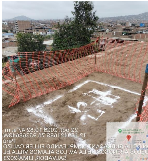
Figura 3. Vista de presencia de material arenoso Av. Los Alamos, villa el salvador. Nota: Elaboración propia
