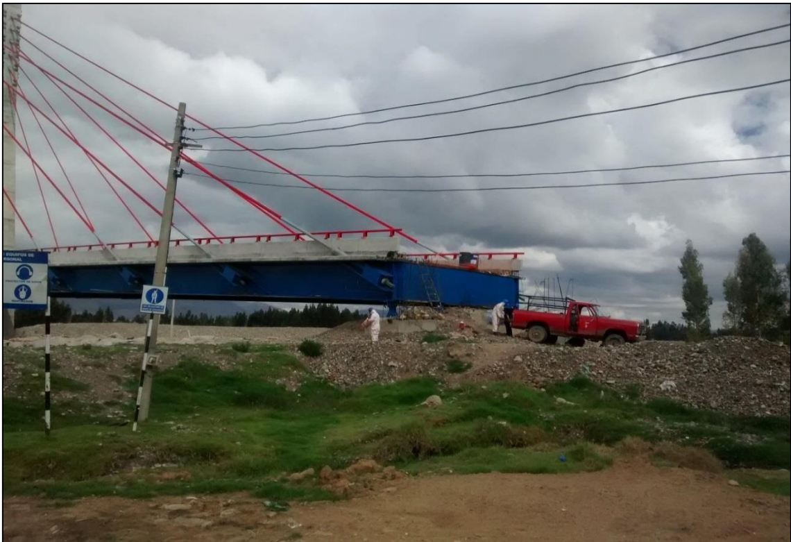
FOTOGRAFÍA N° 2 Vista general del puente Comunerós con los accesos inconclusos.
