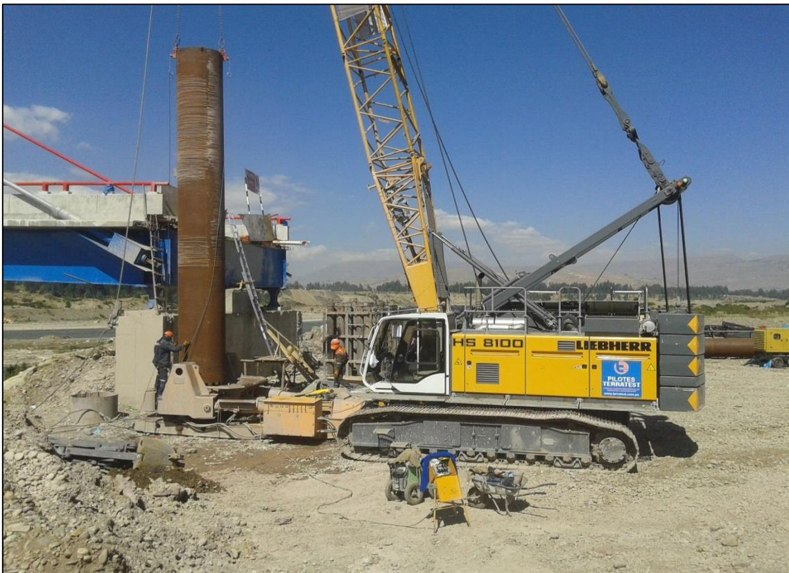
FOTOGRAFÍA N° 14 Izado del ademe o encamizado con apoyo de la grúa de la pilotera.
