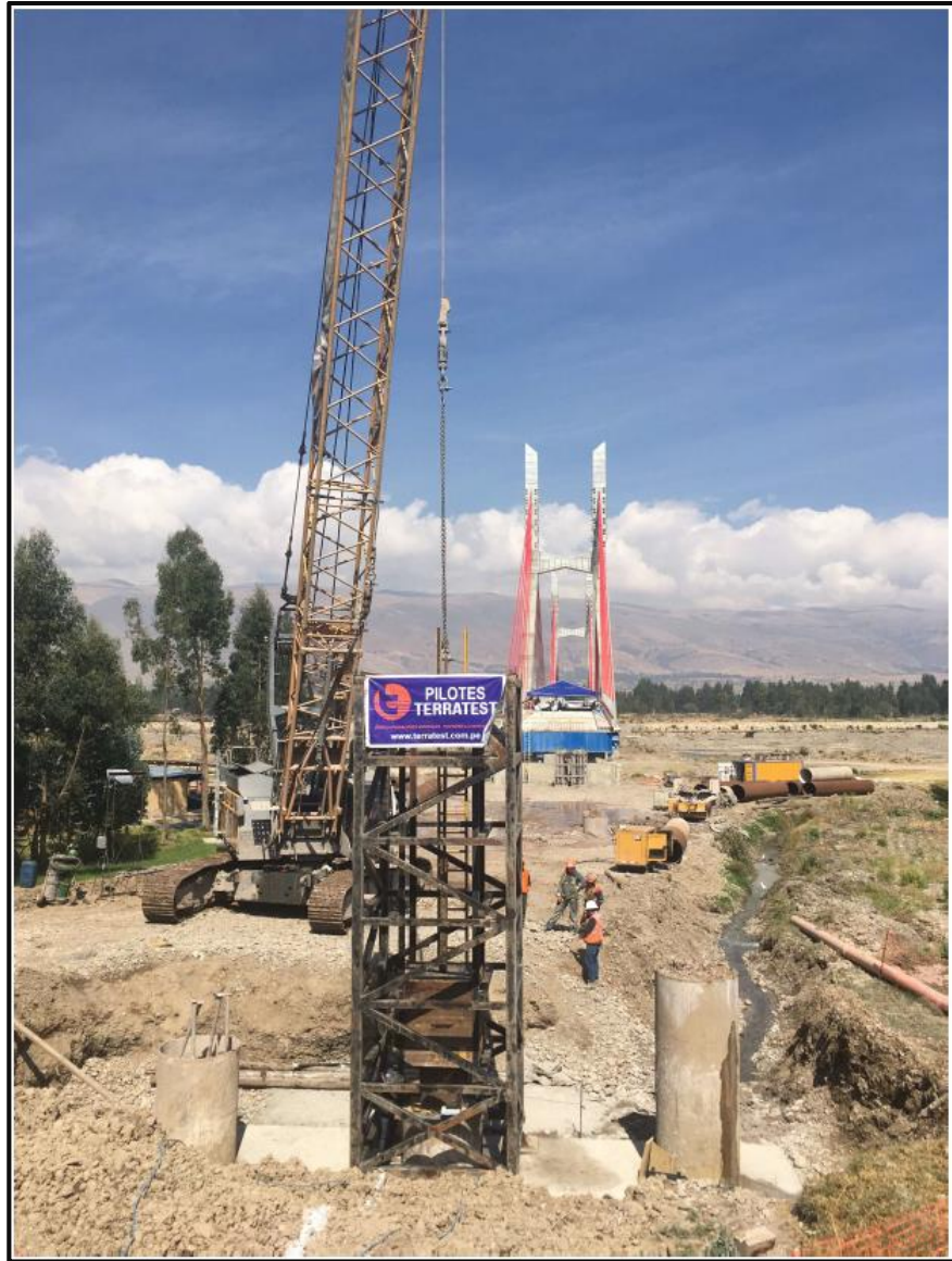
FOTOGRAFÍA N° 4.5 Realización de la prueba de carga dinámica a los pilotes del puente Comuneros.
