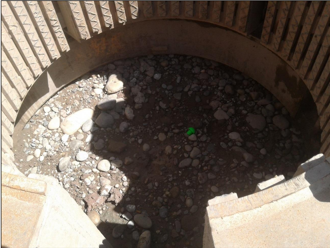
FOTOGRAFÍA N° 13 Fijación del punto de excavación del pilote con el oscilador adherido a la pilotera.
