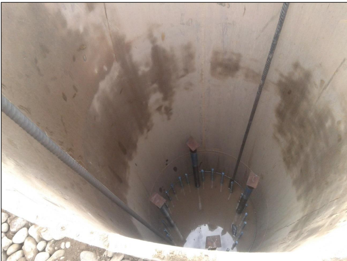
FOTOGRAFÍA N° 22 Encamizado fundido con refuerzo de acero listo para la colocación del concreto.
