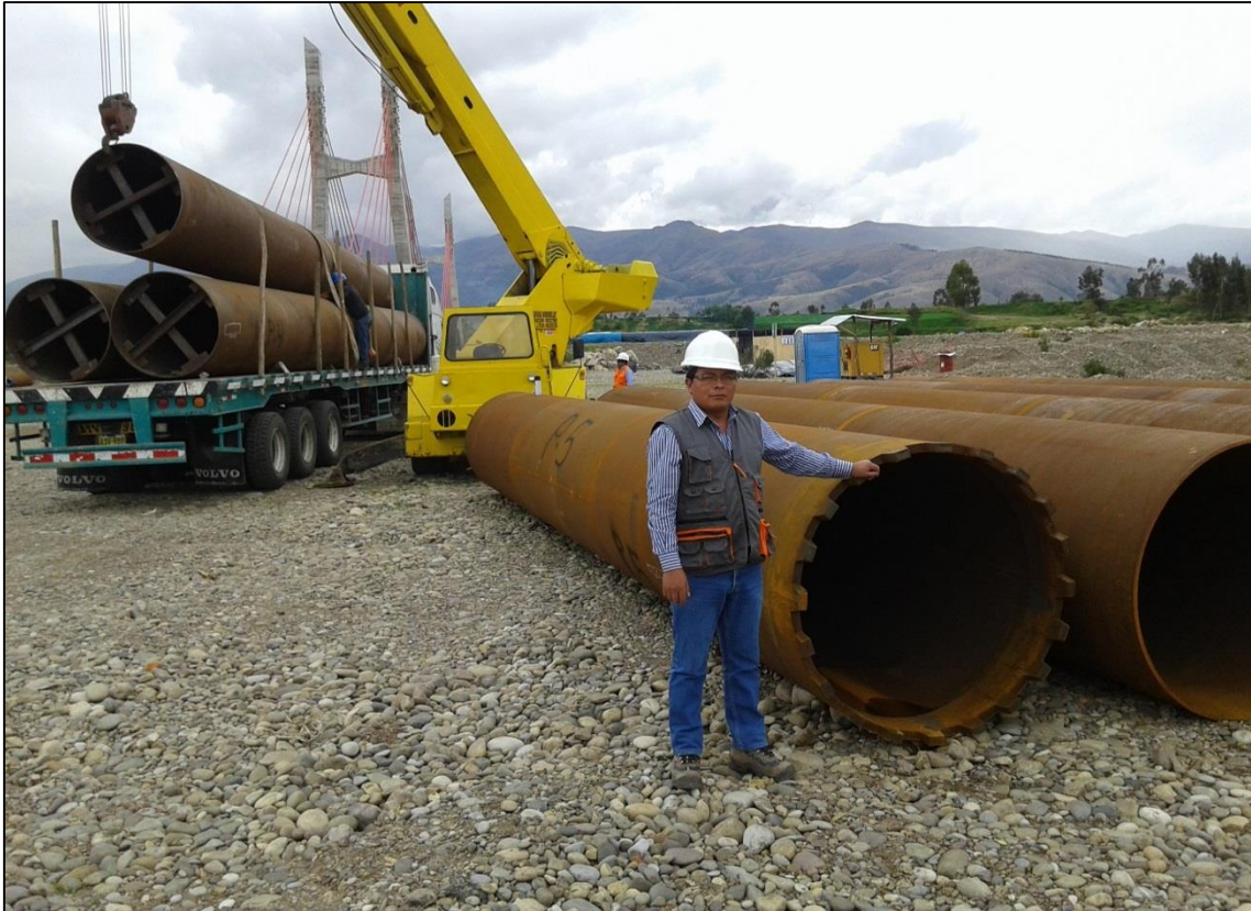
FOTOGRAFÍA N° 11 Encamizados o ademes de acero que se utilizan en la excavación de los pilotes.
