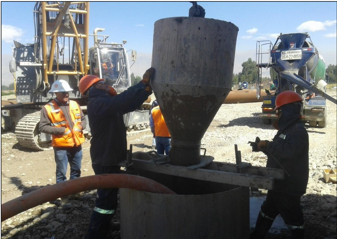
FOTOGRAFÍA N° 24 Embudo de la tubería Tremie siendo ensamblado para la colocación del concreto.
