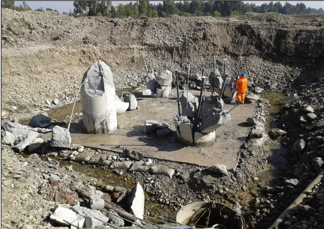
FOTOGRAFÍA N° 35 Descabezado de los pilotes para proseguir con la construcción de la zapata de la súper estructura.
