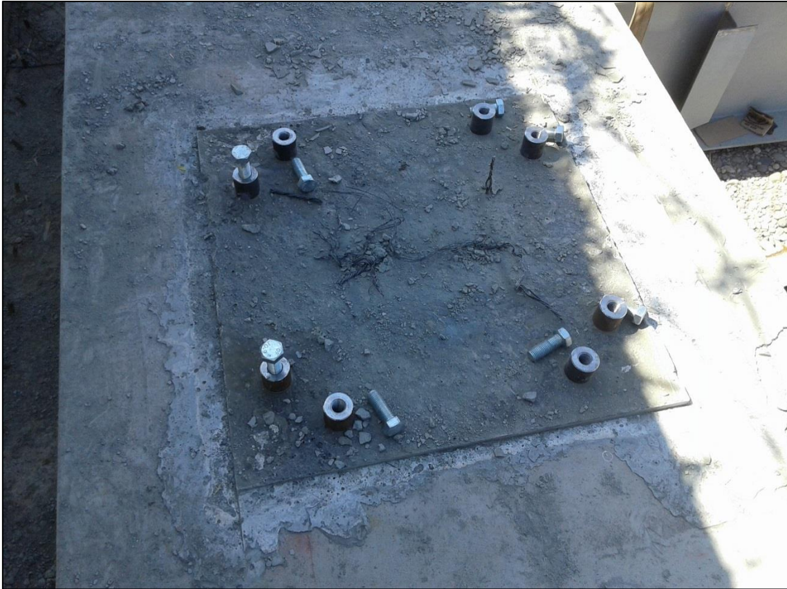
FOTOGRAFÍA N° 41 Base fijada del aislador sísmico.
