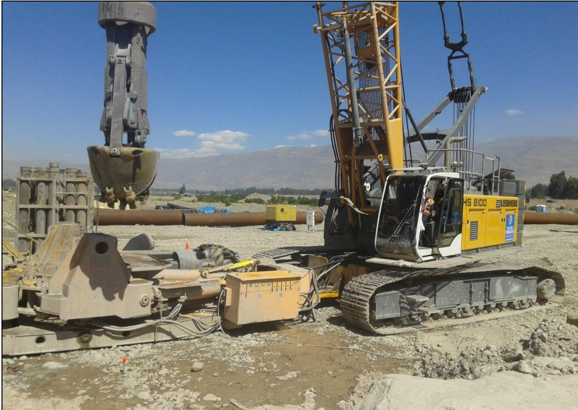
FOTOGRAFÍA N° 17 Inicio de la excavación del pilote con el uso de cuchara de valba dentada.
