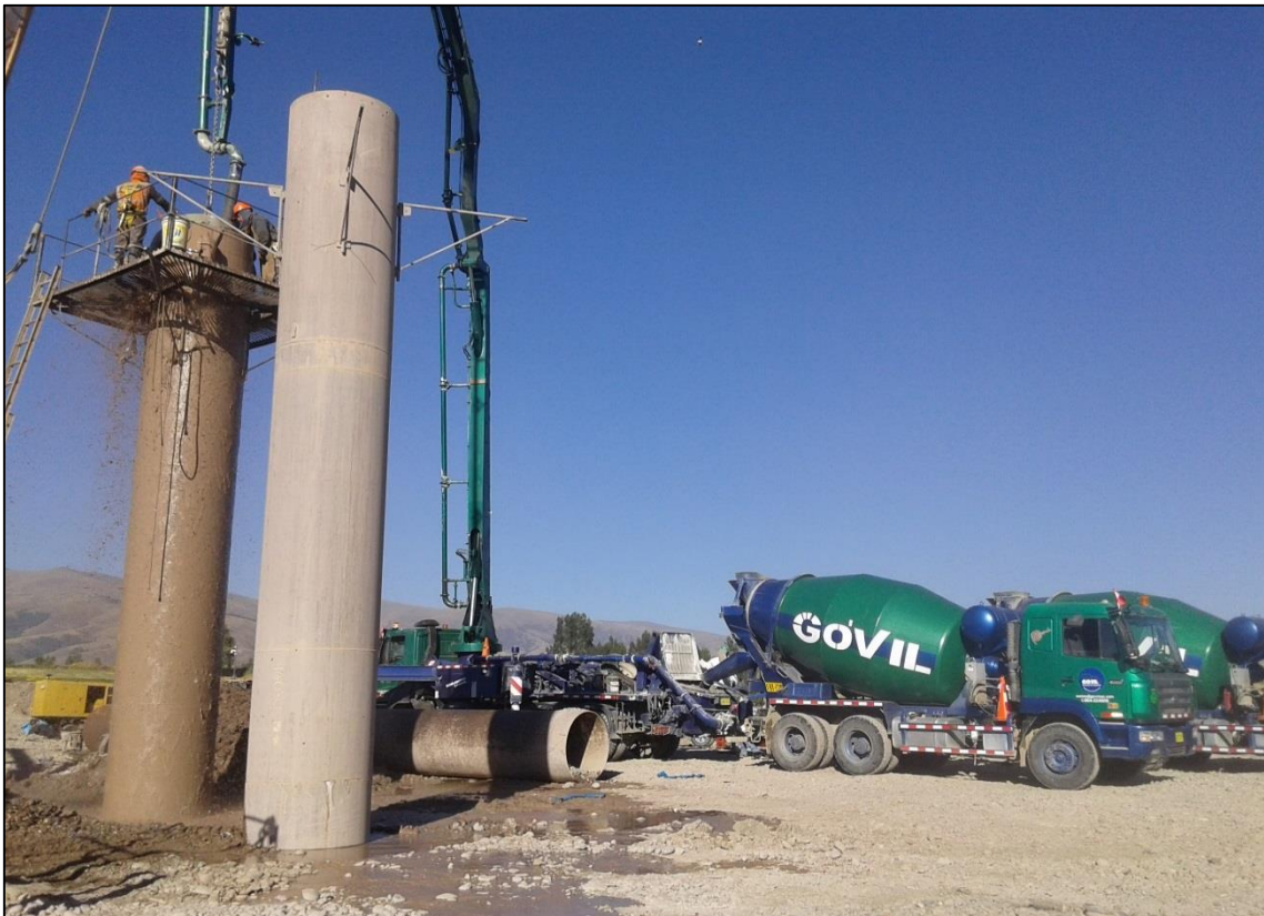
FOTOGRAFÍA N° 26 Adecuación de un sistema de alta meza para la colocación del concreto.
