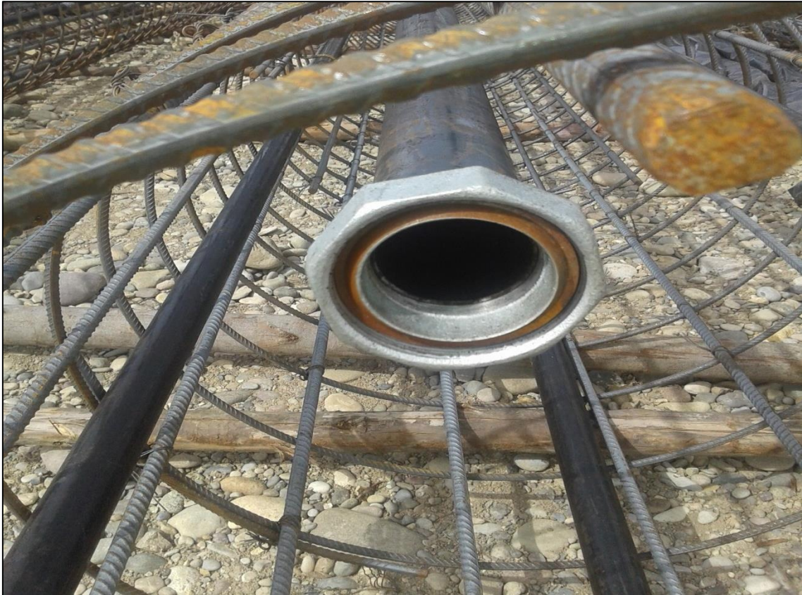
FOTOGRAFÍA N° 10 Emboquillado para la unión de los tubos para el ensayo de Cross Hole Sonic Logging.
