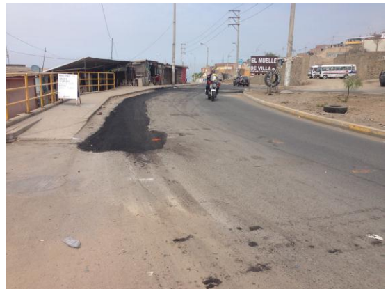
Reparación de la superficie con emulsión asfáltica, ubicada en la curva hacia la Antigua Panamericana Sur, Prog. 6+540.
