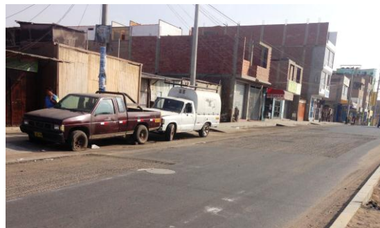
Fresado de superficie existente para la colocación de asfalto en caliente, ubicada entre las progresivas 5+220 – 5+300
