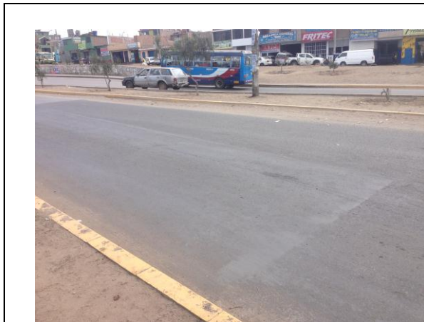
Reparación de la superficie con asfalto en caliente, ubicado cerca al ovalo María Reiche.
