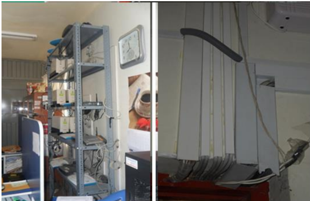
Fig. N° 6: red de datos actual en el área de Contabilidad Fuente: Municipalidad Distrital de Huamancaca. Elaboración: Propia
